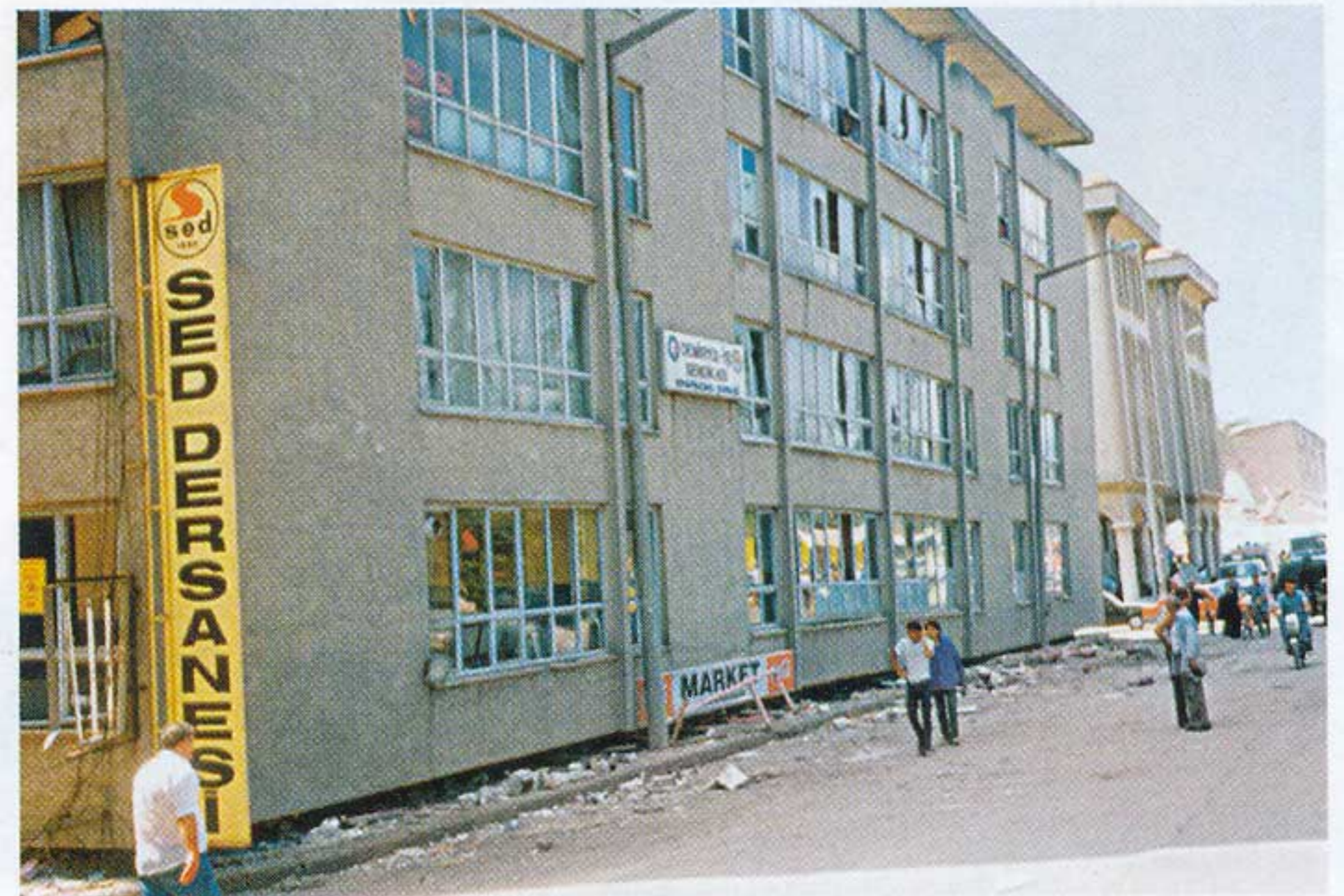
Το κτήριο βυθίστηκε κατά ένα όροφο κατά το σεισμό του Izmit της Τουρκίας. Η πινακίδα του σουπερμάρκετ που βρισκόταν στην κορυφή του ισογείου έγινε ένα με το έδαφος
