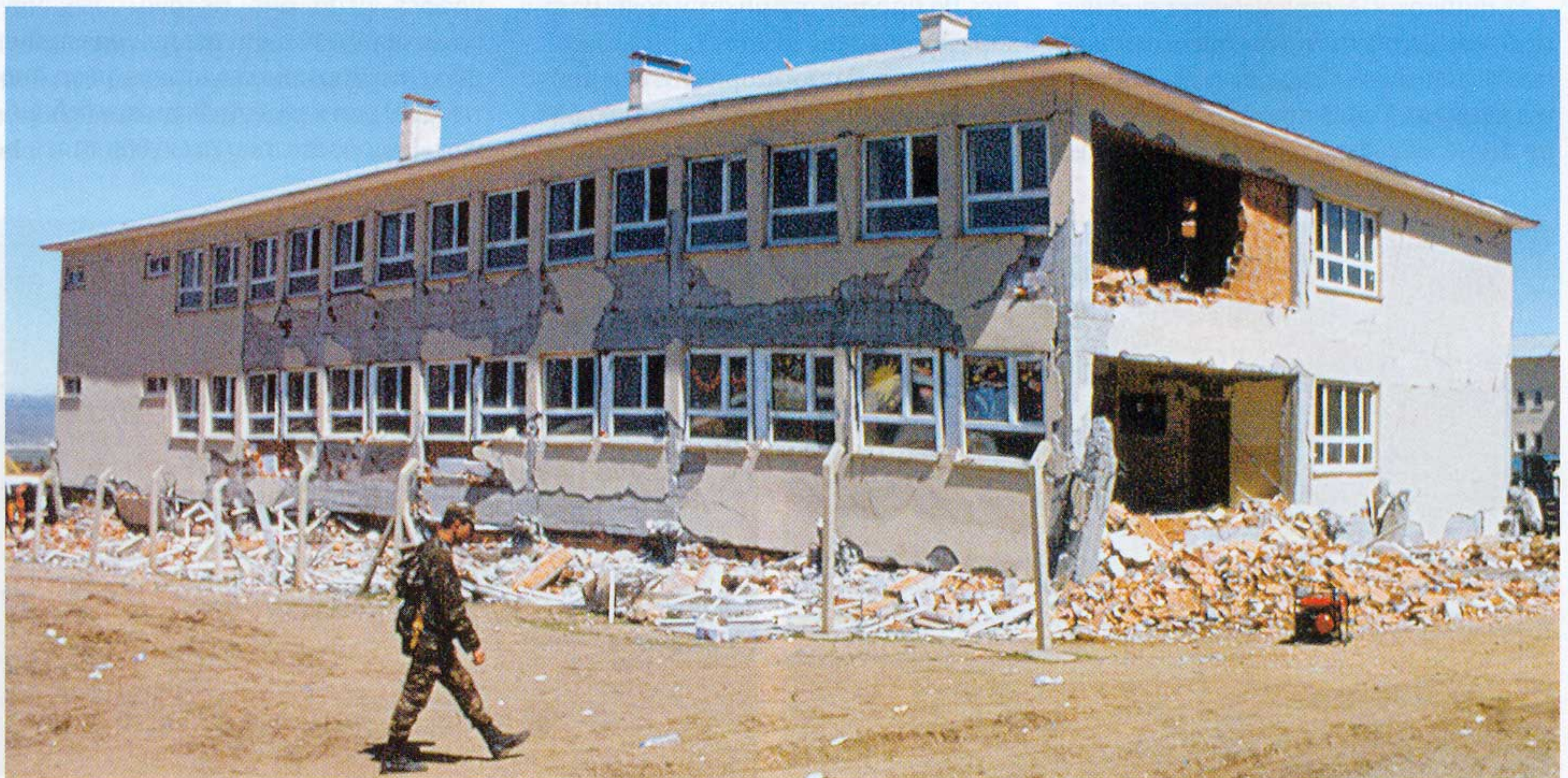
Σεισμός μεγέθους 6,4 R στην πόλη Bingol το 2003. Σ' ένα σχολικό συγκρότημα, το ισόγειο εξαφανίστηκε λόγω των ασθενών υποστηλωμάτων, τα οποία δεν μπόρεσαν να αντεπεξέλθουν στη φόρτιση. Διακρίνονται οι κοιλότητες που έχουν ανοίξει
