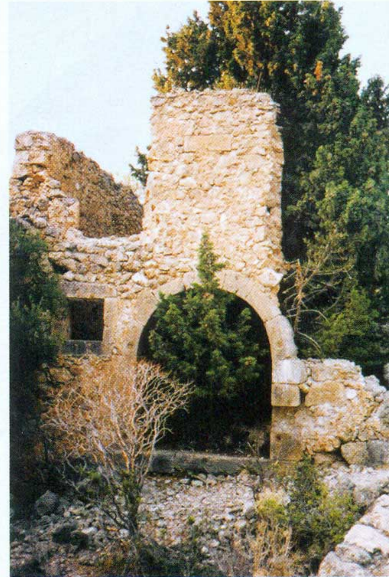
Σεισμός Κεφαλονιάς 1953. Τα τόξα έχουν θαυμαστή αντοχή σε ισχυρούς σεισμούς
