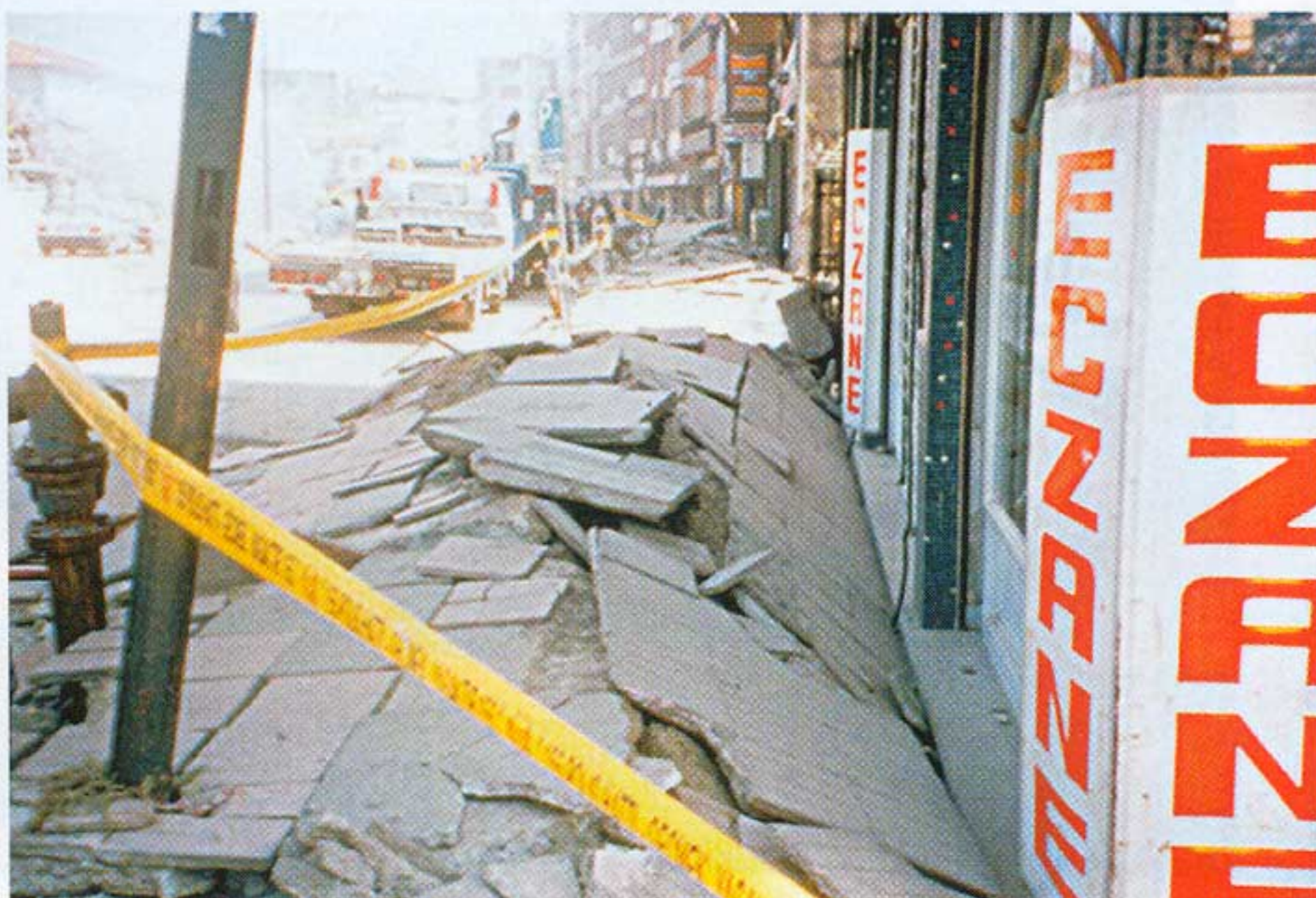
Κατά το σεισμό του Izmit του 1999, μεγέθους 7,4 R, τα κτήρια κινήθηκαν ως προς την οριζόντια διεύθυνση, με αποτέλεσμα η πηλακόστρωση να κυρτωθεί έντονα
