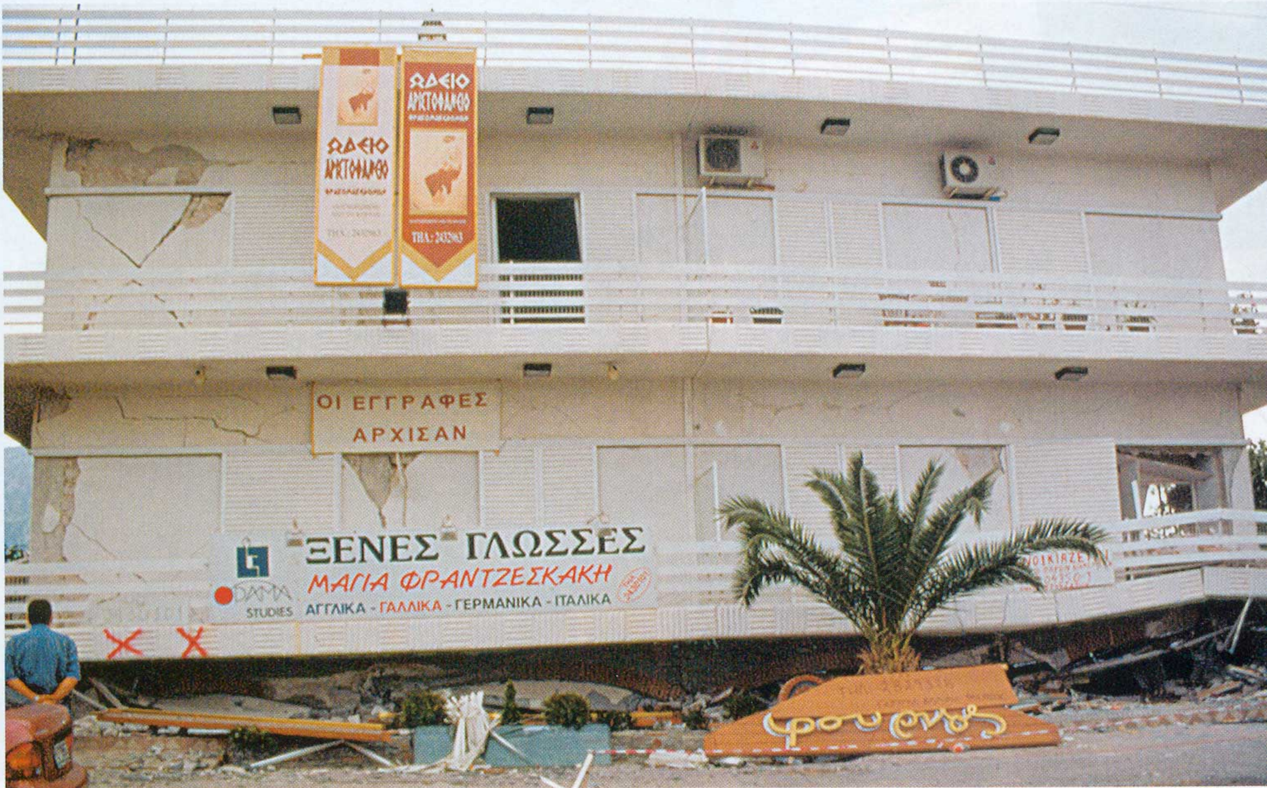
Σεισμός της Αθήνας μεγέθους 5,9 R της 7ης Σεπτεμβρίου 1999. Ένα κτήριο-φροντιστήριο κατέρρευσε 3 ημέρες πριν αρχίσει η σχολική χρονιά. Τριάντα κτήρια, που στέγαζαν φούρνους, κατέρρευσαν στον ίδιο σεισμό στην ευρύτερη περιοχή των Αθηνών
