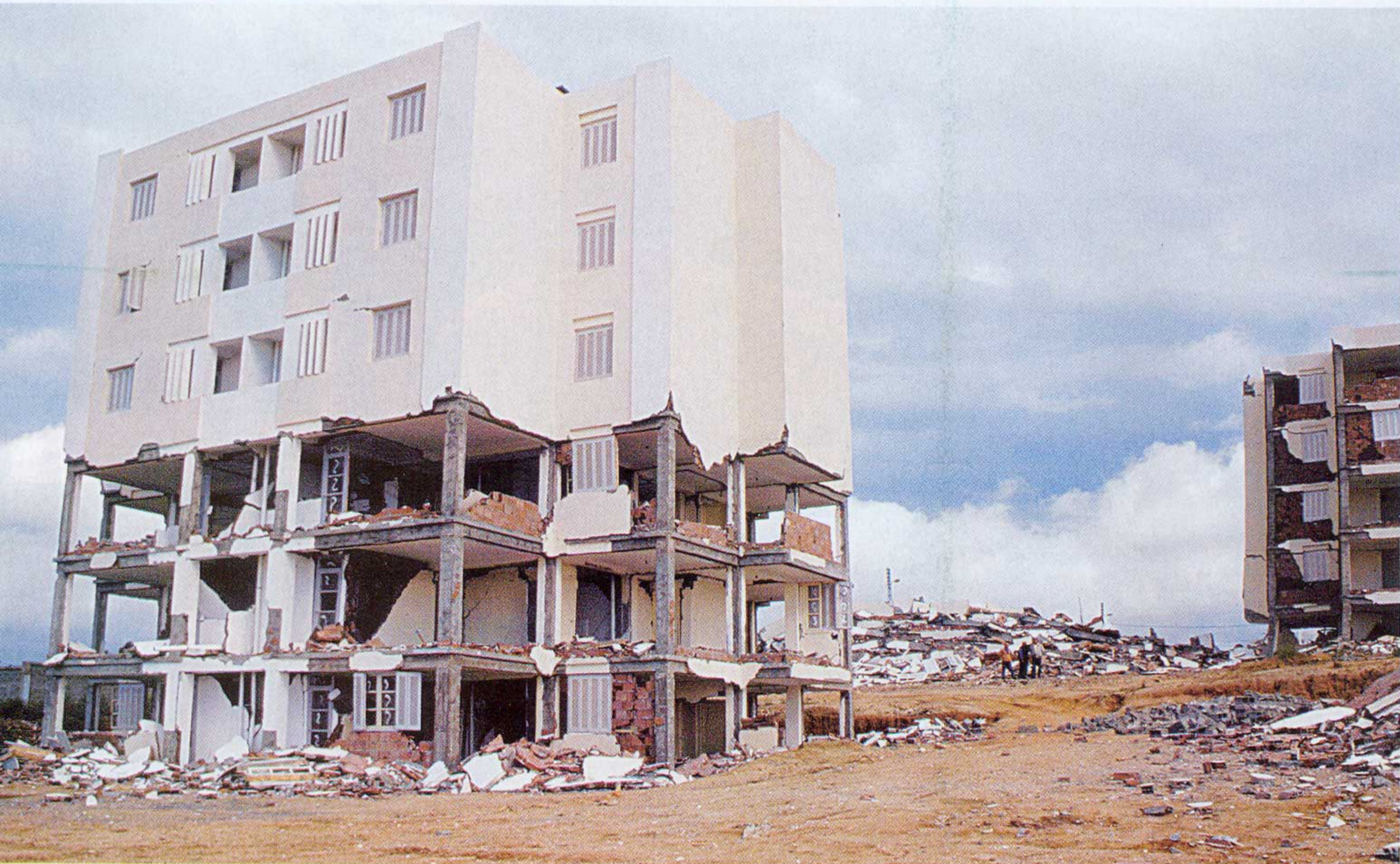
Μοιάζει σαν να του έχουν πέσει τα παντελόνια. Η τοικοποιία των πρώτων ορόφων αποσπάστηκε από το σκελετό, λόγω των έντονων ταλαντώσεων και της ασθενούς σύνδεσής της με τα υποστυλώματα, κατά το σεισμό των 6,8 R του 2002 στην Αλγερία
