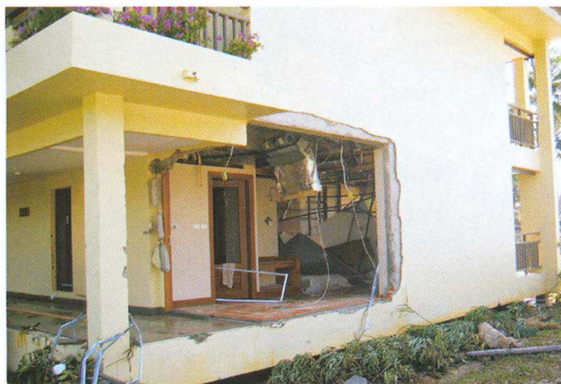
Ινδικός ωκεανός-Ταϊβάνη, σεισμός 9,0 R, κύματα τσουνάμι, Δεκέμβριος 2004. Η πίσω τοιχοποιία εκτοξεύτηκε από την εισβολή του τσουνάμι
