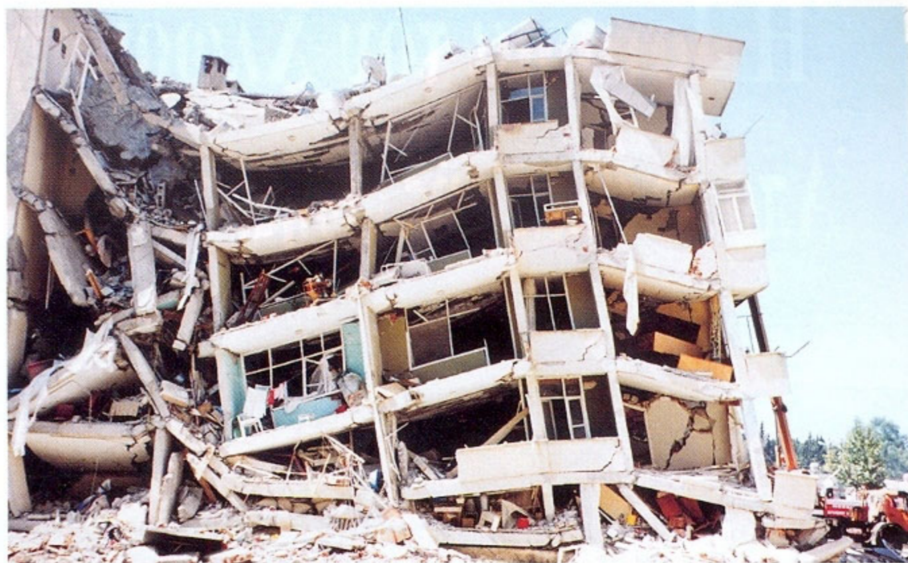
Τό σεισμικό κύμα ἀποτυπώθηκε πάνω σέ αὐτή τήν κατασκευή, ἡ ὁποία σέ ἄλλα τμήματά της συνθλίφθηκε, ἐνῶ σέ ἄλλα παρέμεινε ὄρθια χωρίς νά καταρρεύσει.
