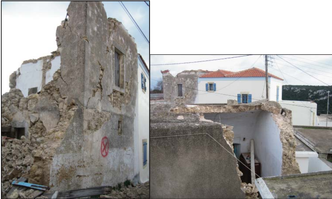
Σχήμα 2. Άποψη σημαντικών βλαβών και καταρρεύσεων σε παλιά πετρώχιστα κτίρια στο χωριό Μητάτα.
