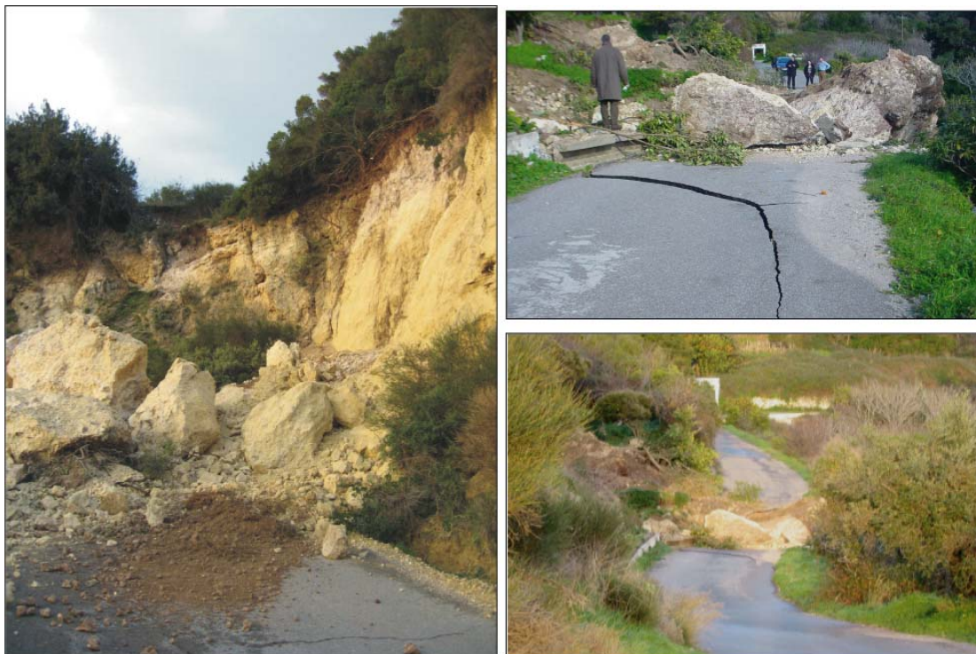
Σχήμα 5. Άποψη των καταπτώσεων και κατολισθήσεων που επηρέασαν το τοπικό οδικό δίκτυο πέριξ του οικισμού Μητάτα. Το μέγεθός τους ήταν περιορισμένο.
