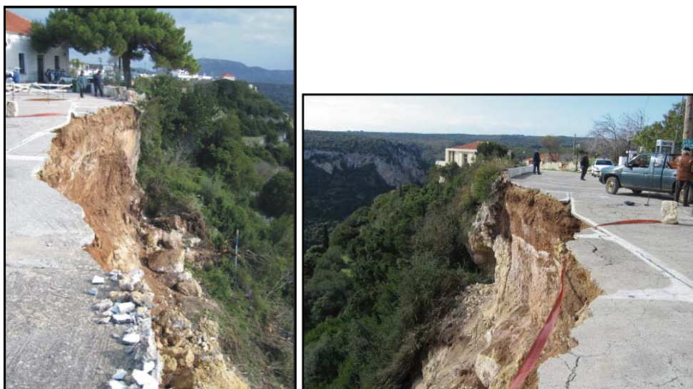
Σχήμα 6. Άποψη της μεγαλύτερης καταγεγραμμένης κατολίσθησης που αποκόλλησε τμήμα της πλατείας του χωριού.
