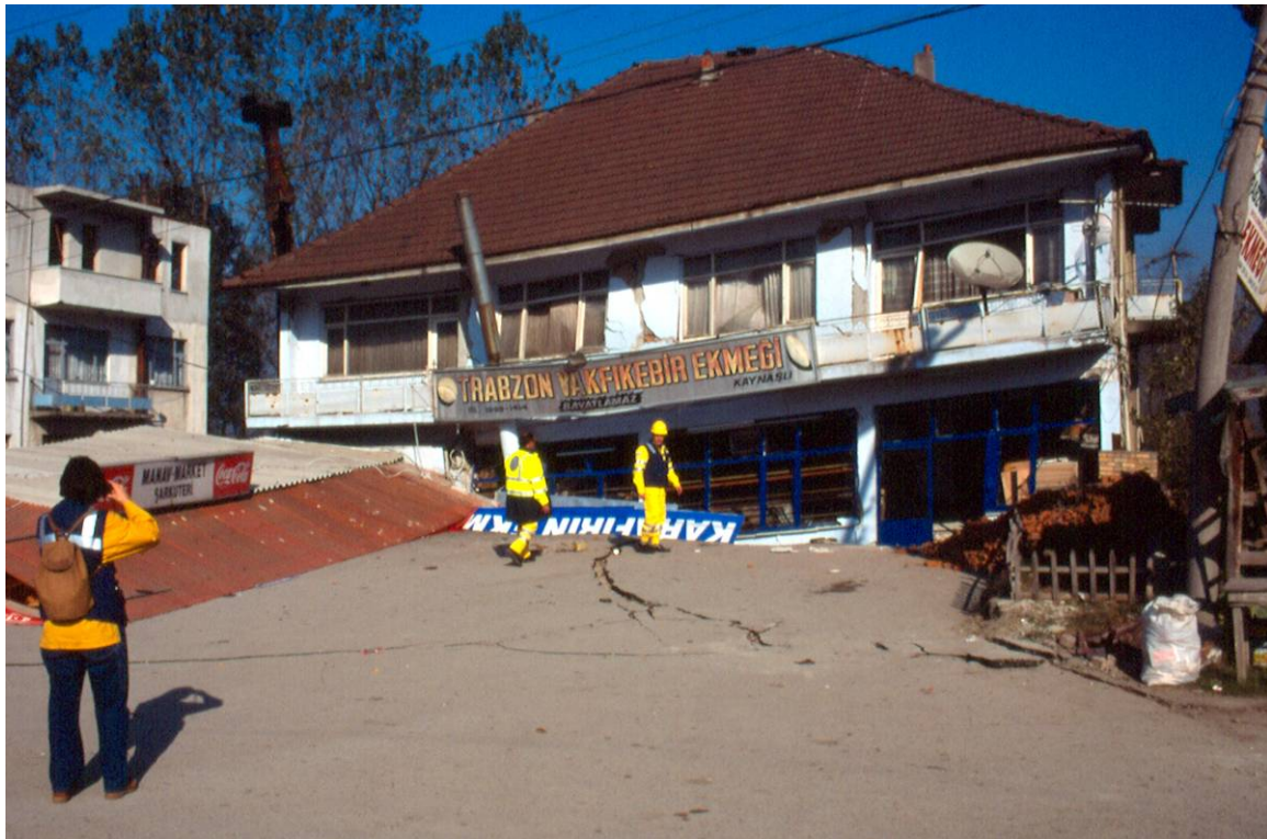
Σχήμα 5. Βύθιση της κτηρίου εντός ανθοειδούς δομής (flower structure) κατά το σεισμό του Izmit.
