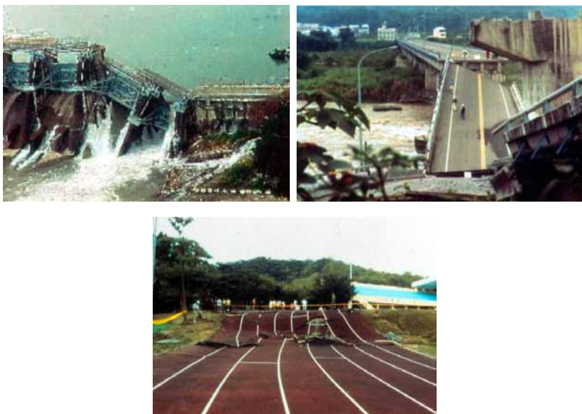
Εικ. 2 Καταστροφή άκαμπτου φράγματος και γέφυρας (πάνω) και παραμόρφωση χώρου άθλησης (κάτω) από τη διέλευση του σεισμικού ρήγματος κατά το σεισμό της 21 ης Σεπτεμβρίου 1999 στην Taiwan.
