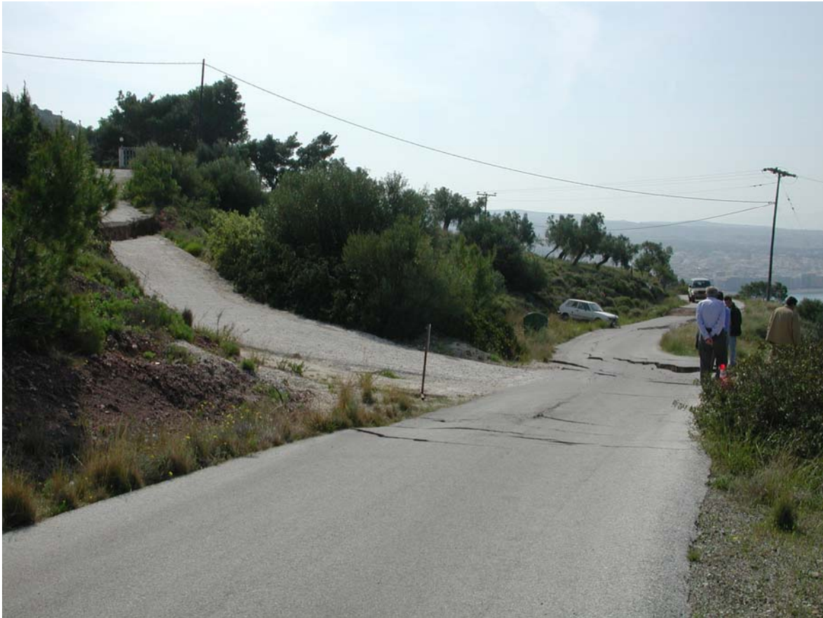
Εικόνα 3: Άποψη της αστοχίας των οδών προς Γηροκομείο Λουτρακίου και της οδού προς την κατοικία
