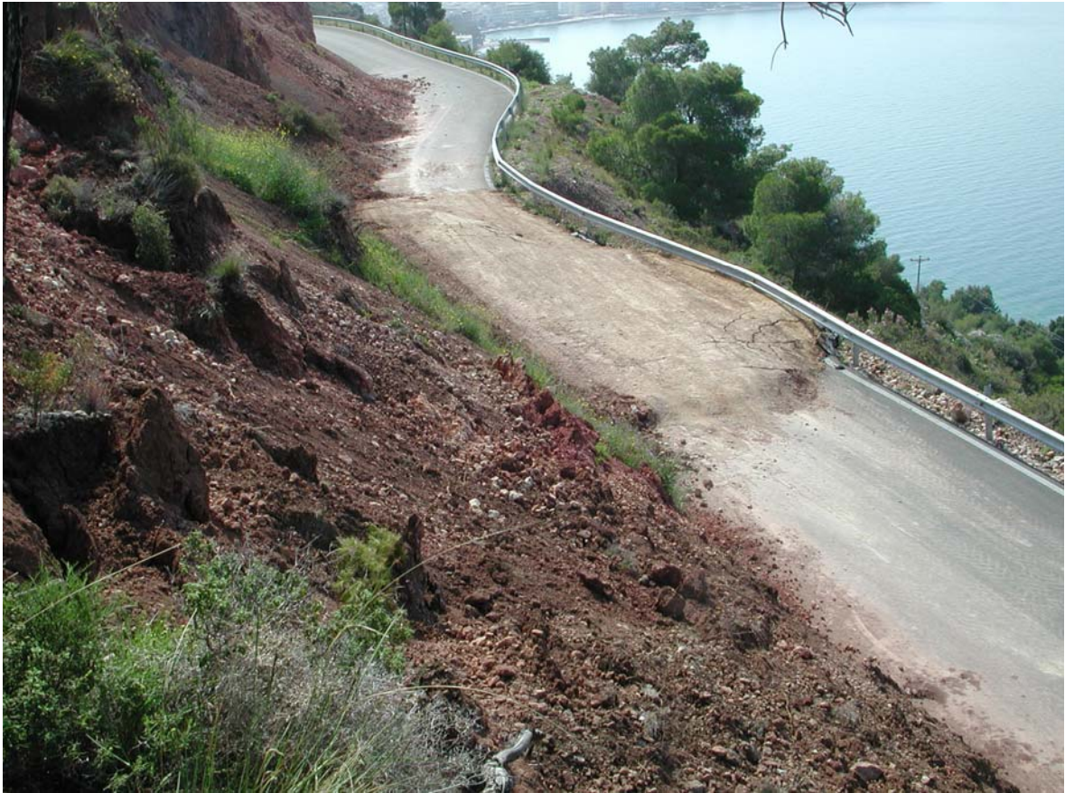
Εικόνα 2: Άποψη της αστοχίας πρανών της παρακαμπτήριας οδού της πόλης Λουτρακίου και του πόδα της κατολίσθησης
