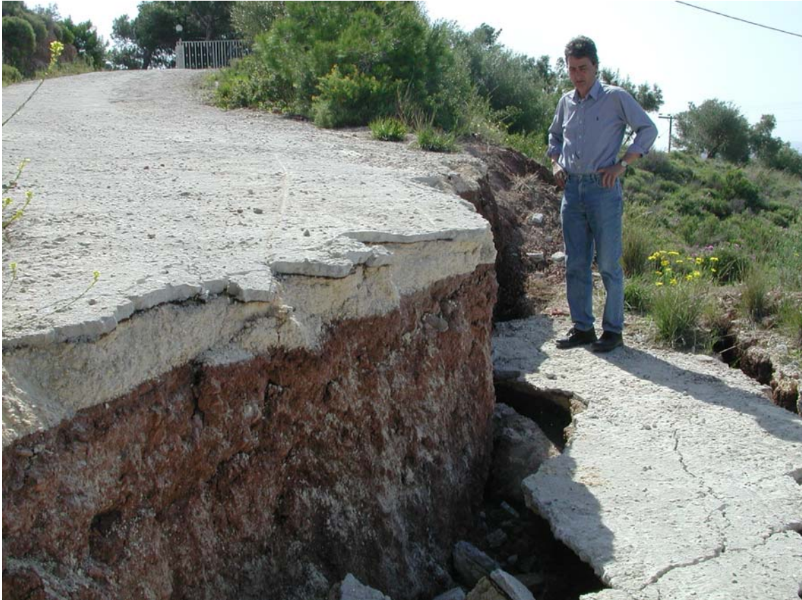
Εικόνα 4: Κατακόρυφη μετακίνηση της τάξης του 1m κοντά στην κεφαλή της ολίσθησης στην οδό προς την ιδιωτική κατοικία
