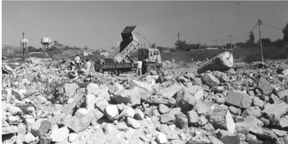
Εικ. 1: Ανεξέλεγκτη απόρριψη αδρανών υλικών που προέρχονται από καταρρεύσεις οικοδομών κατά το σεισμό του Gujarat (Ινδία, 2001).
