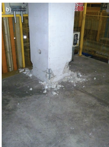
Fig. 25. a) A reinforced concrete structure, in Sant' Agostino ceramic factory, the only recorded damage was around the base of almost all its internal columns; b) There is no shortening of the column at the point of impact. Apparently the damage was caused by tension. Due to this tension the intensity of the impact is augmented, because of the stored energy in the reinforcement. a) Struttura in c.a. nello stabilimento delle Ceramiche Sant'Agostino, l'unico danno osservato è alla base di quasi tutte le colonne interne; b) Non si osserva accorciamento delle colonne nella zona di impatto. Apparentemente il danno è stato causato da sollecitazioni di trazione, che hanno aumentato l'intensità dell'impatto per via dell'energia assorbita dalle armature.
