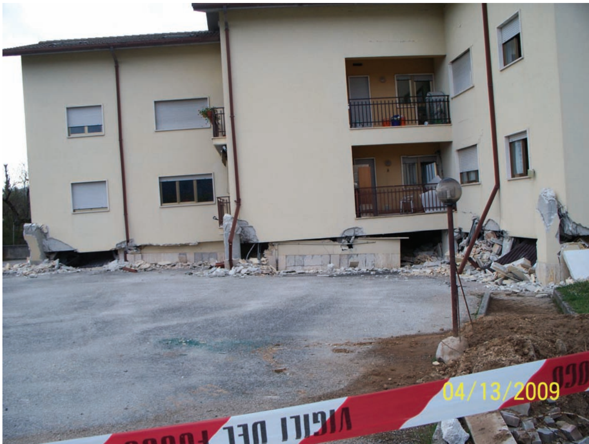
Fig. 24. During the L'Aquila, 2009 earthquake all perimetric columns at the base of the structure were displaced outwards, the building sat down almost vertically, while most of the glass panels remained unbroken, and almost no other damage was optically observed from the outside. Durante il terremoto de L'Aquila nel 2009, tutte le colonne perimetrali alla base della struttura sono state spinte verso l'esterno e l'edificio ha ceduto praticamente in verticale, la maggior parte dei vetri delle finestre sono rimasti intatti, e dall'esterno, non era osservabile quasi nessun altro danno.
